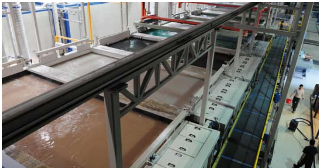
Ванна окупания для очистки, обработки фосфатом цинка и грунтовки
